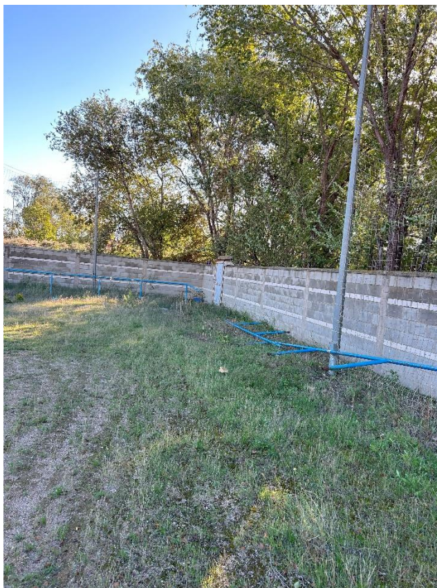
Imagen 7: Foto de la esquina del campo y del mal estado del vallado.
